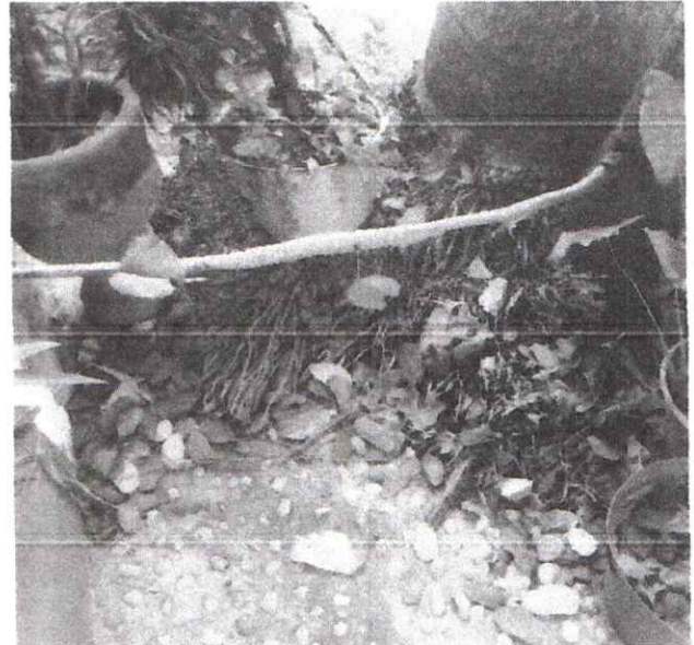
Foto 2. Raíces aérea de la Palma Real, por lo cual esta sobre la infraestructura (banqueta).
